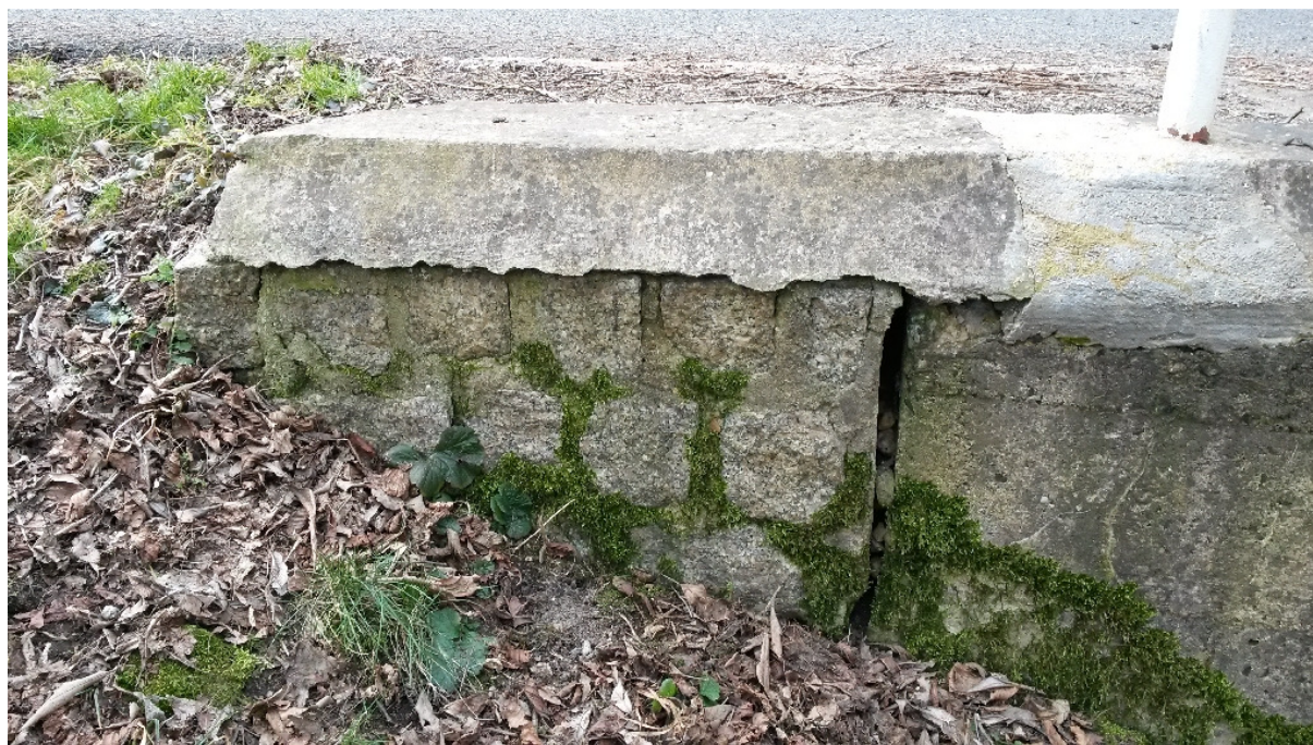
Obr.5 – Pohled na most – rozpadlá závěrná zídka u křídla při nátokové straně
