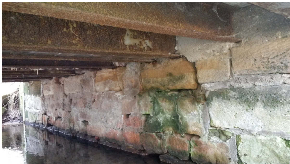
Obr.10 – Pohled levobřežní opěru – absence pojiva mezi kameny
