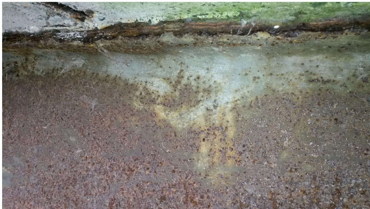
Obr.7 – Pohled na krajový nosník nosné konstrukce s korozí při výtokové straně mostu
