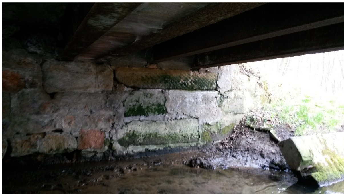
Obr.9 – Pohled pravobřežní opěru – panelové křídlo zasahující do průtočného profilu
