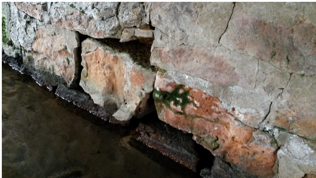
Obr.8 – Detail lokálního oslabení dříku opěry – absence pojiva mezi kameny
