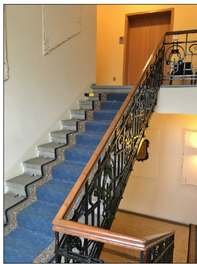
instalovat chybějící madlo
