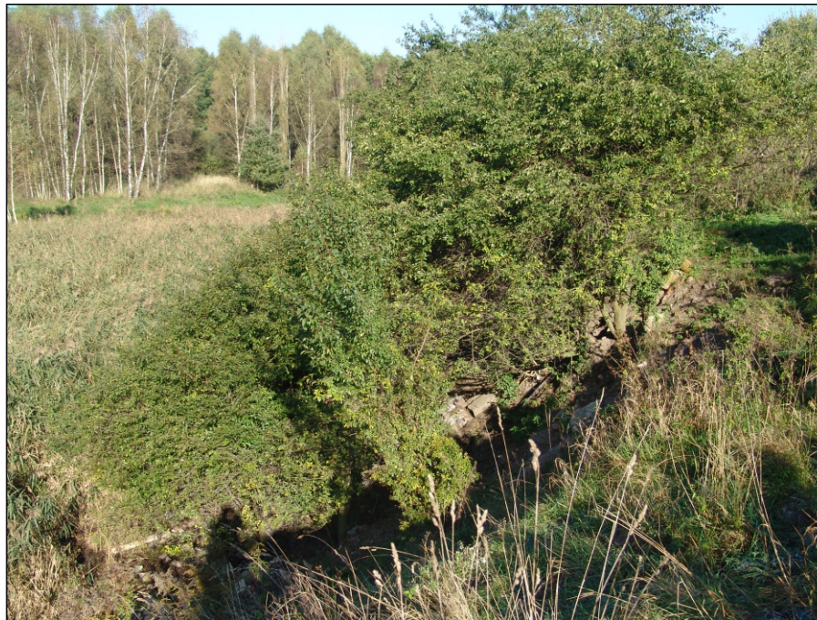
Foto č.3 Svah skládkového tělesa v jižní části
